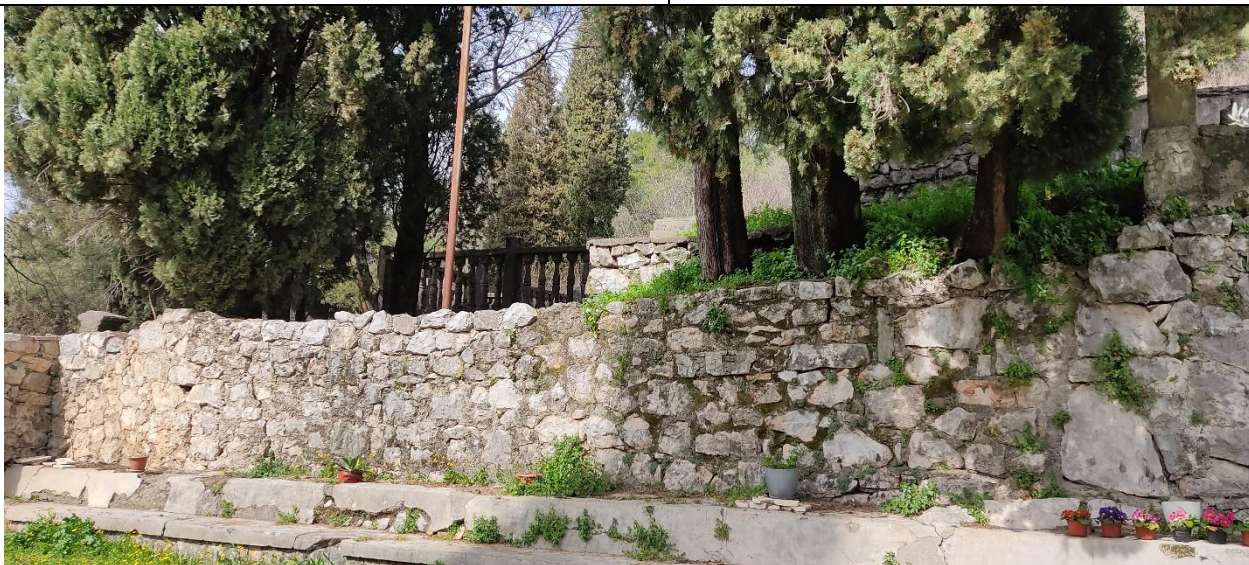
Oštećenja na sjevernom zidu porte
